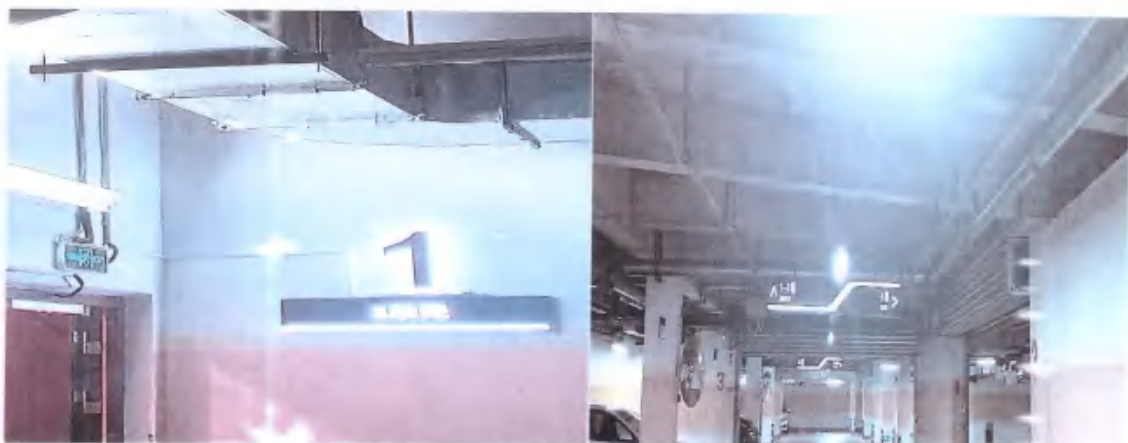
地下室指引灯，照亮业主回家的路，倍感温馨
