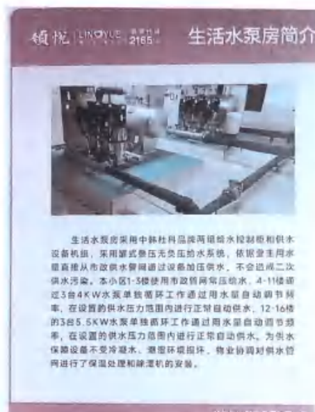
生活水泵房的介绍，让工作人员清楚设备的使用与维护
